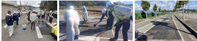
△ 近隣自治体も含めた試行の見学(高知県) △ 自治体職員による施工の実験(上山市) △ 舗装工法の施工完成状況(南陽市)
